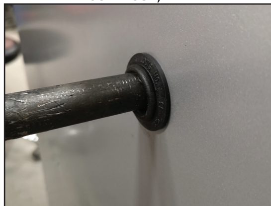
FIGURE 28 - RACCORDEMENTS DE LA CONDUITE DE GAZ DE LA FOURNAISE (NOTEZ L'ANNEAU EN CAOUTCHOUC)
